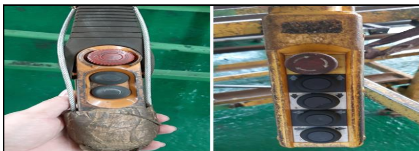
Figura 8 – Controle das talhas elétricas
