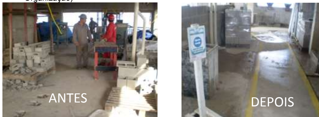
Figura 2 – Antes e Depois no pavimento da central de Argamassa (Senso de Utilização de Espaço e Organização)
