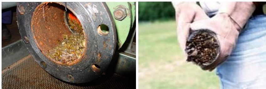
Figura 2: Tubulação incrustada pelo Mexilhão Dourado. (Foto a esquerda de Rodrigo de Felippo. Foto à direita de Gustavo Darrigran).
